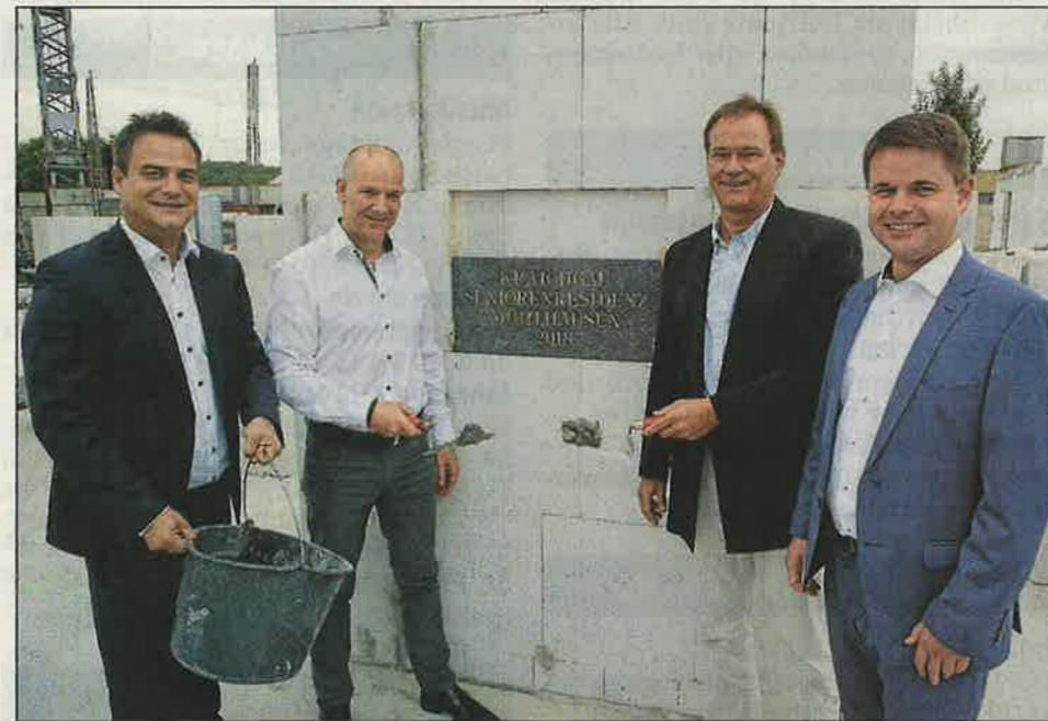
Vor Wintereintritt soll der Rohbau stehen: Die Arbeiten für die neue Seniorenresidenz in Mühlhausen sind in vollem Gange, nachdem am Freitag der Grundstein mit Gedenktafel gelegt wurde: von (v.li.) Martin Hiller (Vitalis Care), Architekt Günther Eppler (Aktiv Wohnbau), Investor Rainer Rudolf und Bürgermeister Jens Spanberger. Fotos: Pfeifer
